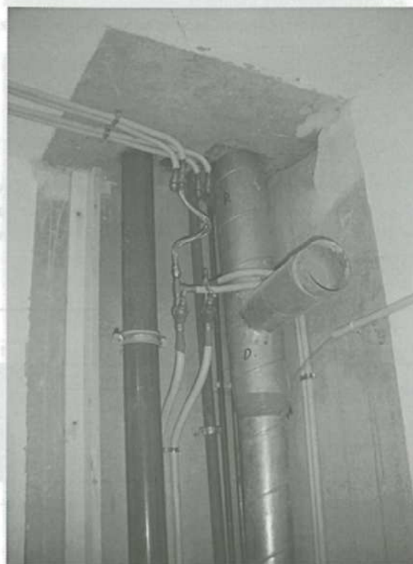
'Loze' waterleidingen zijn aangesloten met een flexibele slang, waardoor 'dood' water kan worden vermeden.
