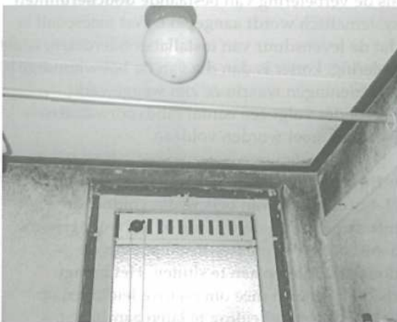
De ventilatie van doucheruimten in oudere woningen is vaak onvoldoende, wat leidt tot vochtoverlast en schimmels.
