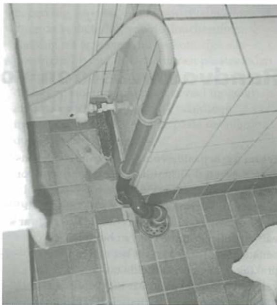
Het ontbreken van afschot en onvoldoende afvoer kenmerken de wat oudere douchevloer.
