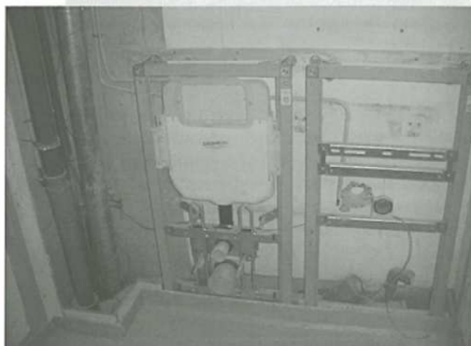
Achter de installatiewand bevinden zich aansluitingen voor wastafel en toilet, die onderling makkelijk zijn te verwisselen.
