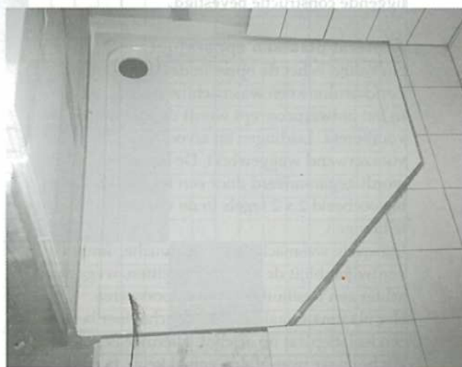
Douchebak, opgenomen in een verhoogde vloer.
