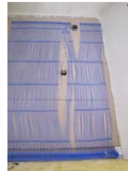
LTV afgifte via capillaire leidingen in de stucplaat. Toegepast als wand-, vloer- en plafondverwarming
